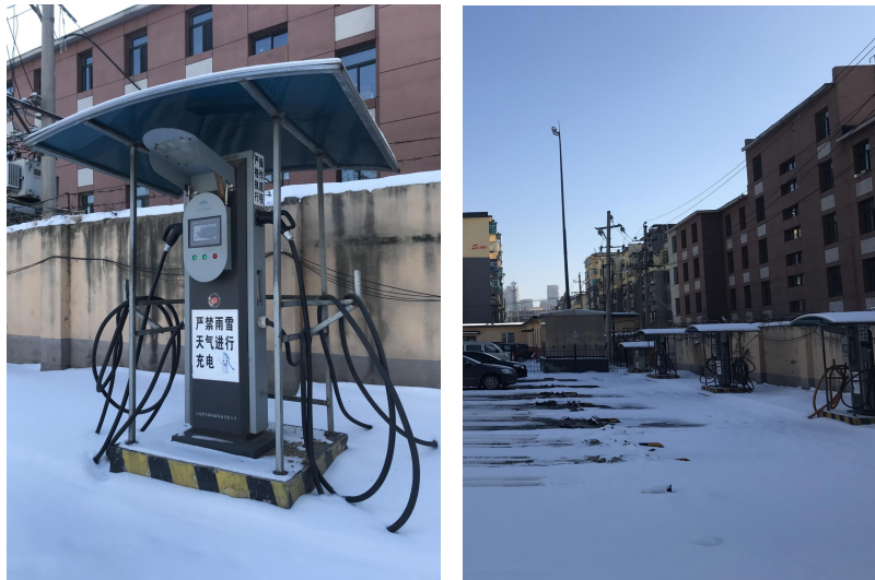
现状公交专用充电站
